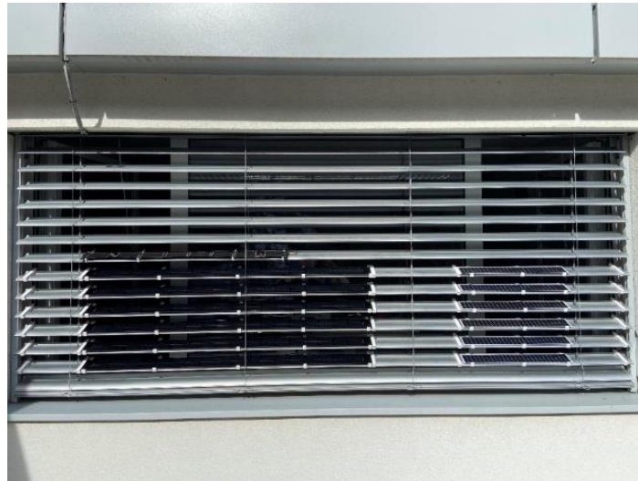
Abbildung 23: Fenster des HELLA InnovationLab mit integrierten PV-Modulen
