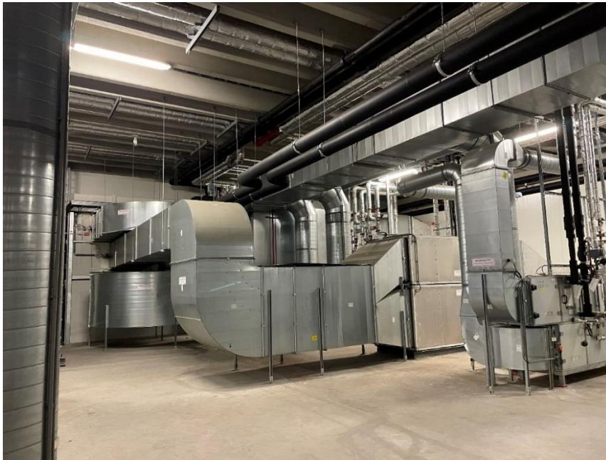
Abbildung 3: Lüftungsanlage bei Coca-Cola HBC Österreich
