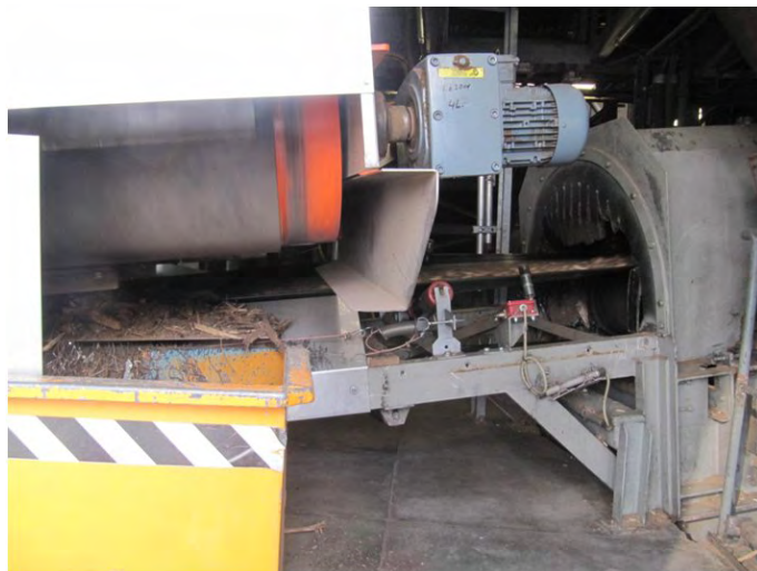
Abbildung 2.23: Eisenabscheider der Brennstoffaufbereitungsanlage der Biomasseanlage Timelkam
